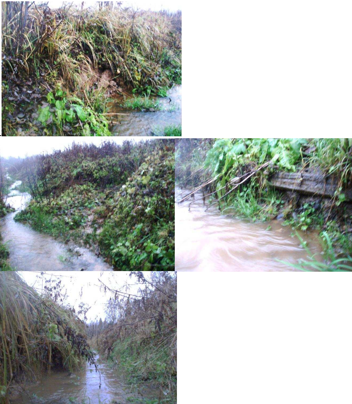
Joonis 4.4. Deformeerunud kraav Lota objektil.
